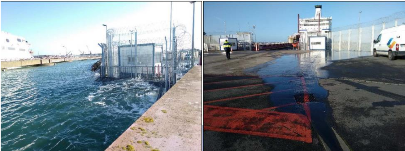
Constat de submersions occasionnelles
